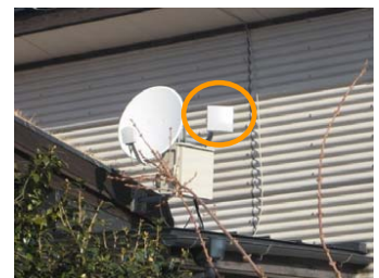
民家に設置したパッチアンテナ
