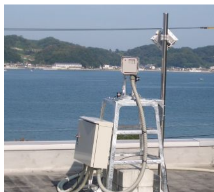
屋上の無線装置
