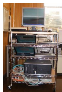
室内に設置されたSW, 計測用機器
